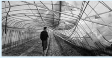
大雪により被害を受けたパイプハウス
