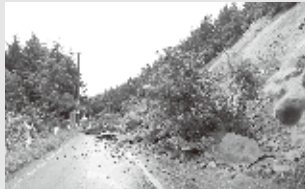
9月の大雨による土砂崩れ(国道459号立石地内)
