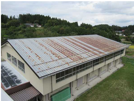
金属屋根の劣化（岩代中学校 体育館）
