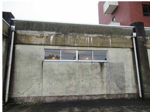
外壁の劣化（東和中学校 校舎棟）
