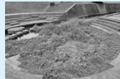
六角川堆積土砂
