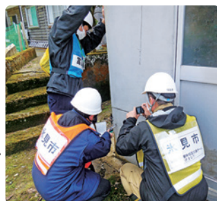
被害家屋の傾き測定の様子
