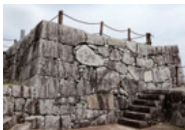
東日本大震災による被災状況
