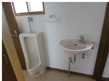
1階 事業スペーストイレ
